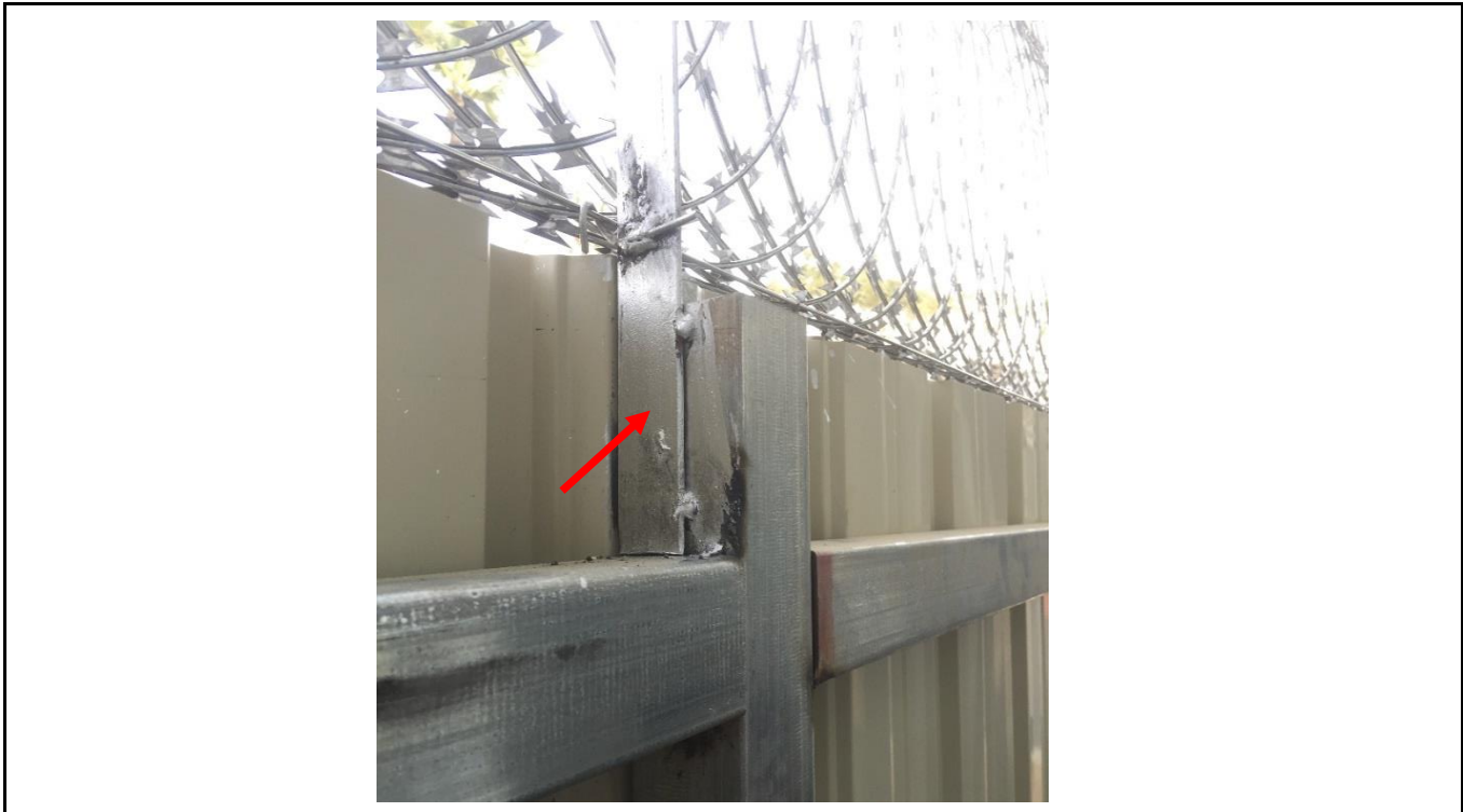
Fig:(35) 4-Angle Fencing's Vertical frame နှင့် ဘလိတ်စားဆူးကြိုး အမာခံ Frame အား welding tacking နှစ်ချက်ဖြင့် တွယ်ဆက်တပ်ဆင်ထားမှုသည် ခိုင်ခံ့မှုအားနည်းနေသောကြောင့် အနည်းဆုံး welding tacking သုံးချက်ဖြင့် တွယ်ဆက်တပ်ဆင်ပေးရန်။
