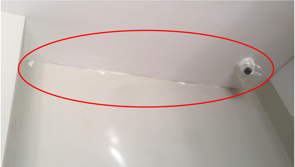
Fig:(47) Ground floor နှင့် First floor ရှိ Ceiling ဧရိယာများ၏ ထောင့်ချိုးနေရာများတွင် စုပ်ချက်သပ်ရန် ကျန်ရှိနေခြင်းနှင့် ဆေးများကွက်နေသည်ကို ပြုပြင်ပေးရန်။
