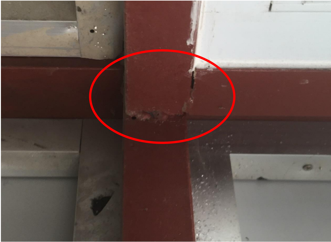
Fig:(55) Mobile security gate ရှိ Composite installation work ၏ အမာခံ G.I Hollow frame များတွင် Welding သားအပြည့်ဆော်ထားခြင်းမရှိသဖြင့် ပြုပြင်ပေးရန်။
