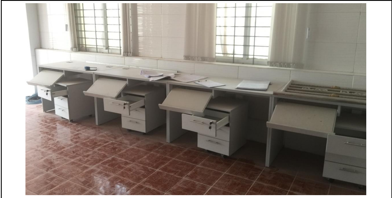
Fig:(22) Ground floor နှင့် First floor ရှိ Counter များအားလုံးတွင် Drawer များ၏ ဘရိတ်မပါရှိသဖြင့် ပြုပြင်ပေးရန်။
