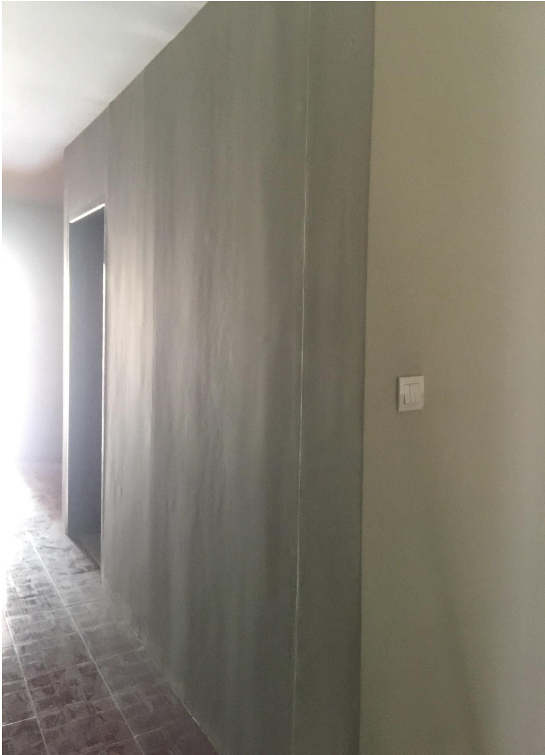
Fig:(50) Store room-Ground floor ၏အတွင်းအပြင် Partition wall ဆေးများလှိုင်းထနေခြင်း နှင့် ဆေးကွက်နေခြင်းများအား ပြုပြင်ပေးရန်။
