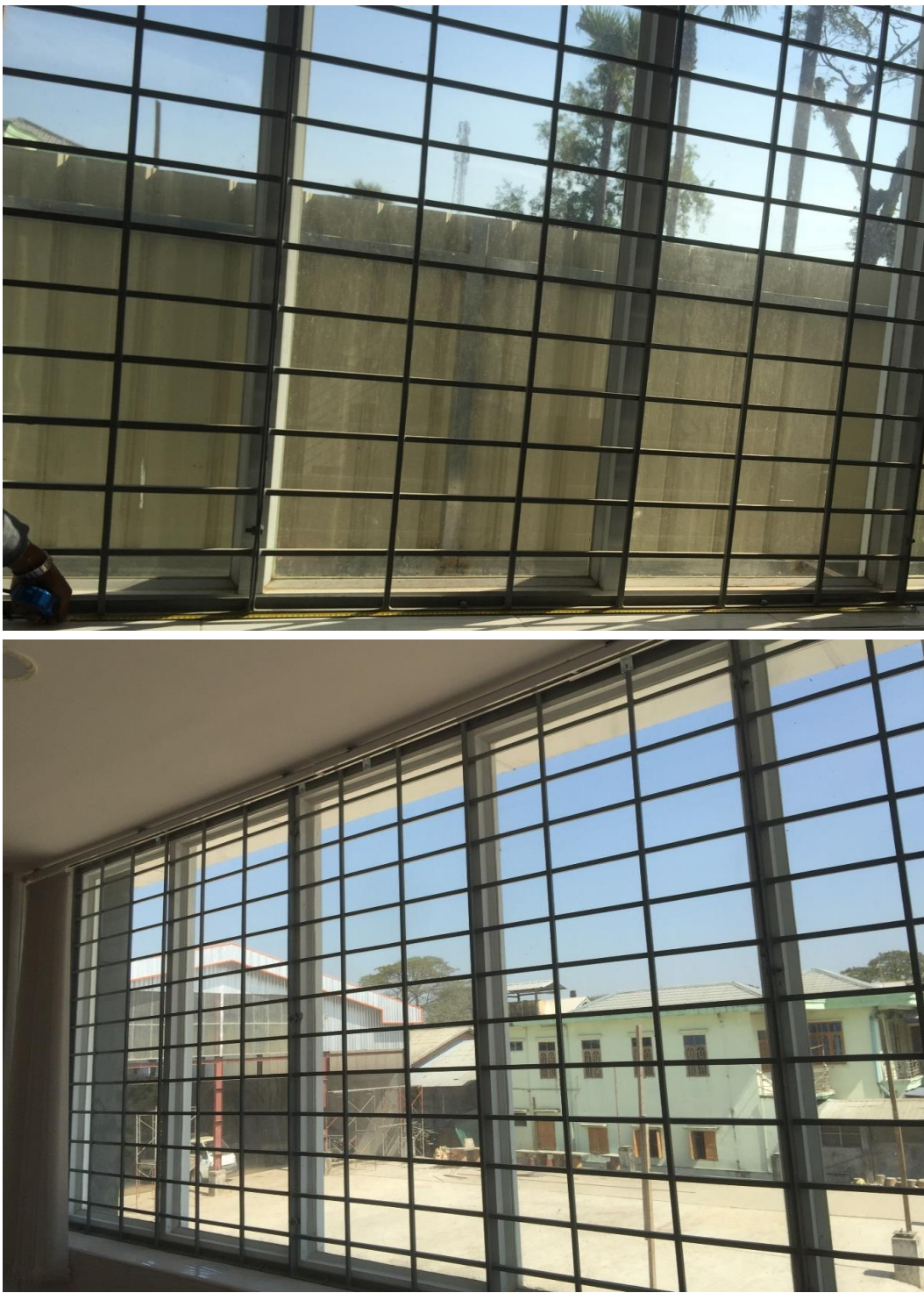
Fig:(42) Ground floor (GL-C/4-5) ရှိ W05 နှင့် First floor ရှိ W03 (2nos) & W04 ၏ Irongrill Work (Over 20 FS) တွင် ထပ်တိုး Vertical frame (1"x3/16" thk; M.S Flat) အား စာချုပ်တွင် 4' c/c တပ်ဆင်ရန် သတ်မှတ်ထားသော်လည်း On site တွင် Alu: window frame span နှင့်လိုက်၍ အမြင်လှစေရန် 5' c/c တပ်ဆင်ထားပါသဖြင့် စာချုပ်နှင့် ကွဲလွဲနေပါသည်။ (မှတ်ချက်-ခိုင်ခန့်မှုရှိ၍ ပြန်ပြင်စရာ မလိုပါ။)
