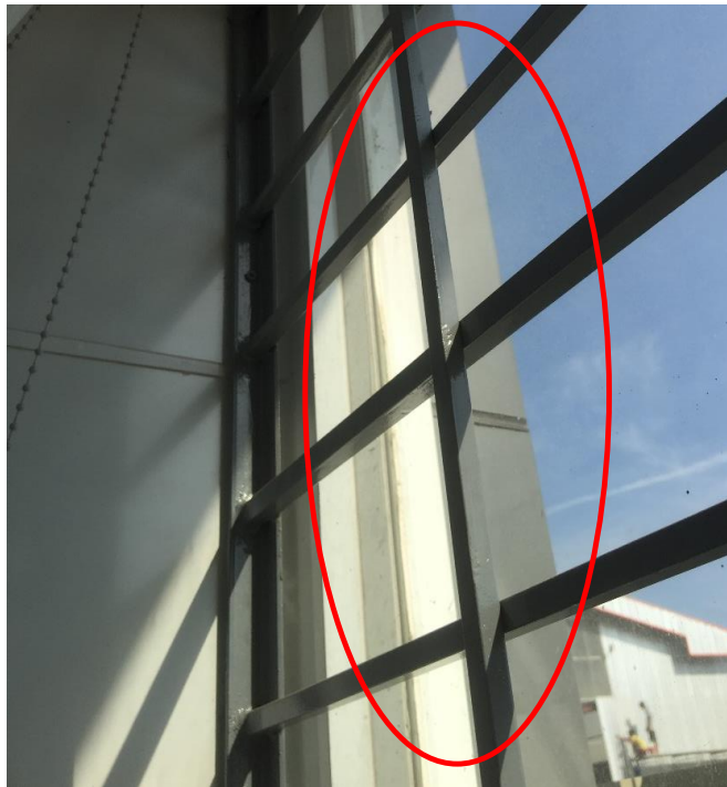
Fig:(46) Ground floor နှင့် First floor ရှိ Irongrill တစ်ချောင်းချင်းစီအား On Site တွင်ဘေးတစ်ဖက်သာ Welding ဆော်ထားပါသဖြင့် နောင်လုပ်ဆောင်မည့်လုပ်ငန်းများတွင် Irongrill တစ်ချောင်းချင်းစီ၏ ဘေးနှစ်ဖက်လုံး Welding အပြည့်ဆော်ပေးရန်။ (ယခုတွင် ပြန်ပြင်စရာမလိုပါ။)
