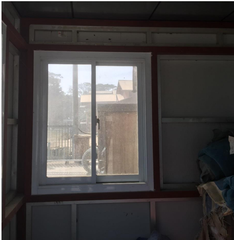
Fig:(57) Mobile security gate ရှိ Composite installation work တွင် Composite board ကပ်ခြင်းလုပ်ငန်းအား Security gate ၏ အပြင်ဖက်ခြမ်းကိုသာ ကပ်ထားပြီး အတွင်းဖက်ခြမ်းကိုကပ်ထားခြင်းမရှိသည်ကိုညှိနှိုင်းပြုပြင်ပေးရန်။
