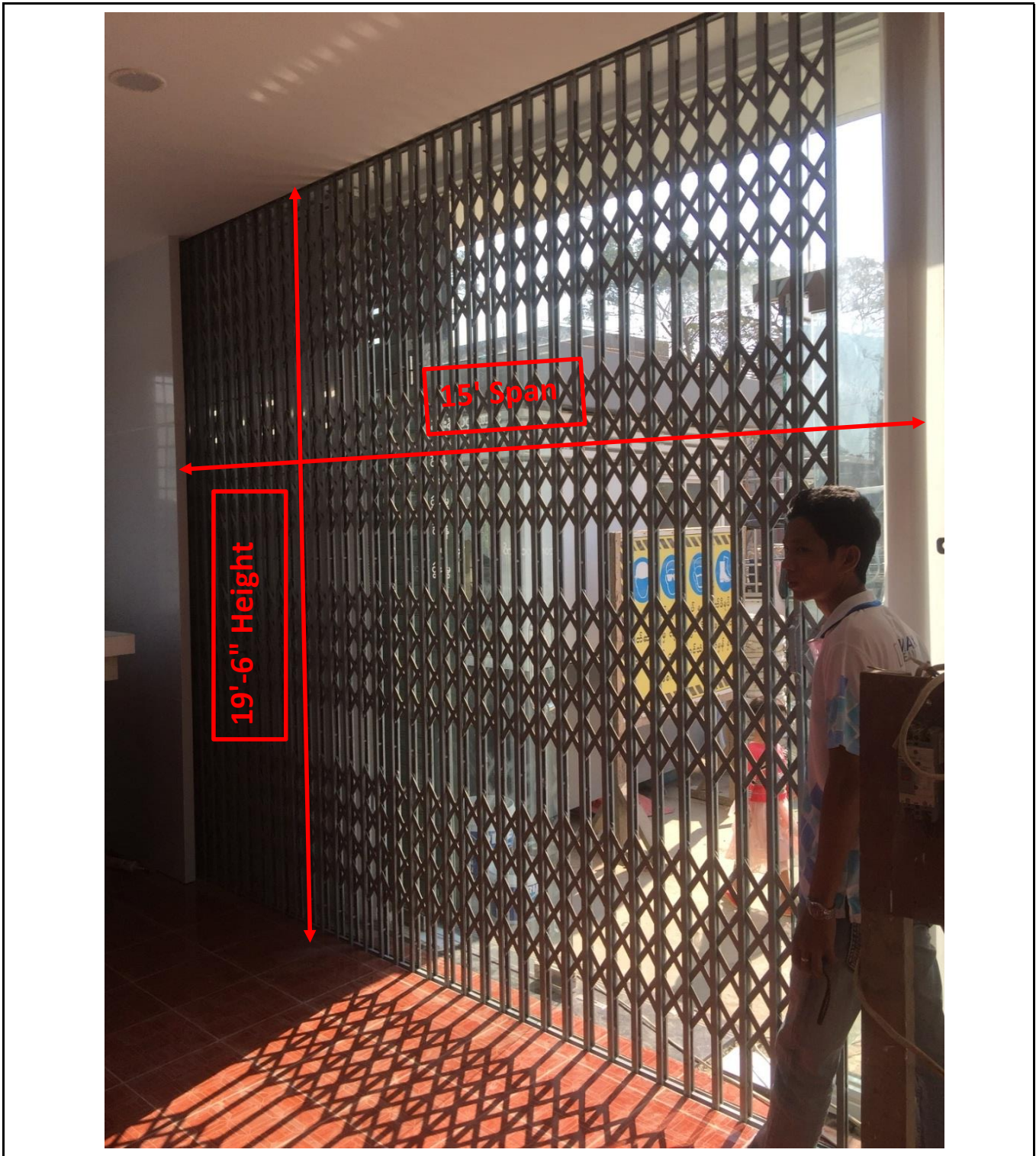
Fig:(30) Ground floor ရှိ Entrance Bajar Door (Span-15', Height-9'-6" တွင် တံခါးရွက်တစ်ရွက်ဖွင့်သာပြုလုပ်ထားသဖြင့် အဖွင့်အပိတ် ကြပ်နေသည်၊ လေးနေသည်ကို ပြုပြင်ပေးရန်။
