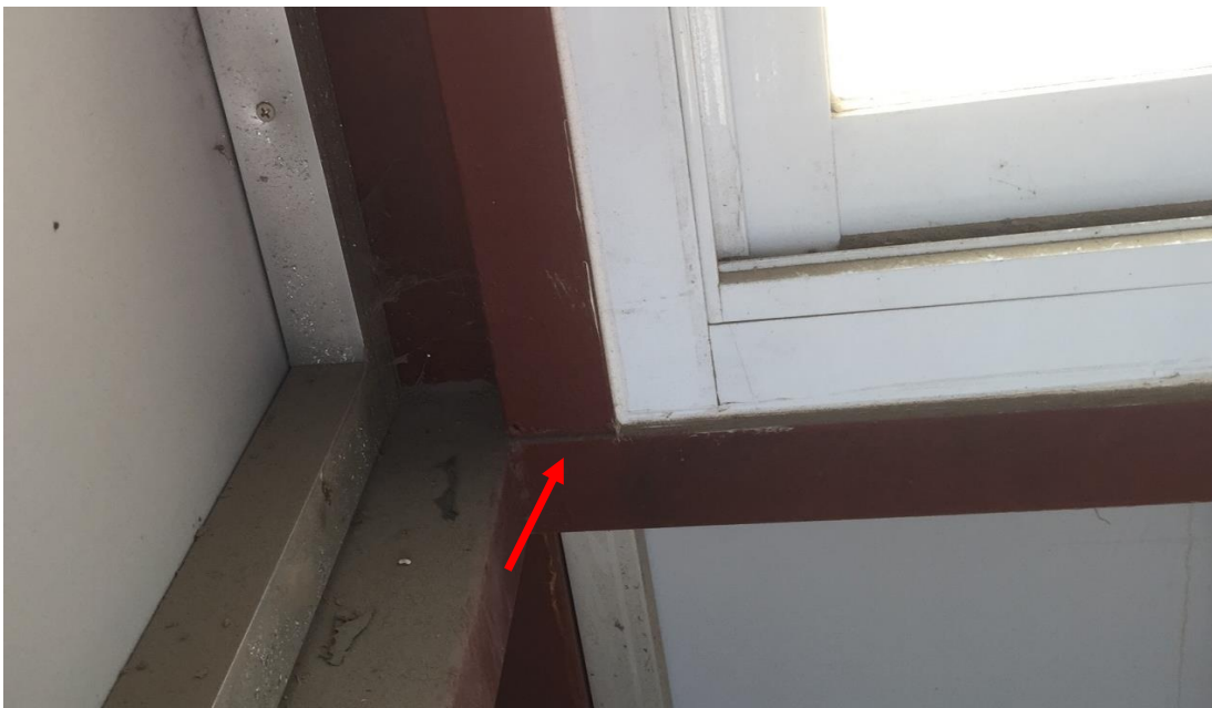
Fig:(56) Mobile security gate ရှိ Composite installation work ၏ အမာခံ G.I Hollow frame များတွင် Welding သားအပြည့်ဆော်ထားခြင်းမရှိသဖြင့် ပြုပြင်ပေးရန်။
