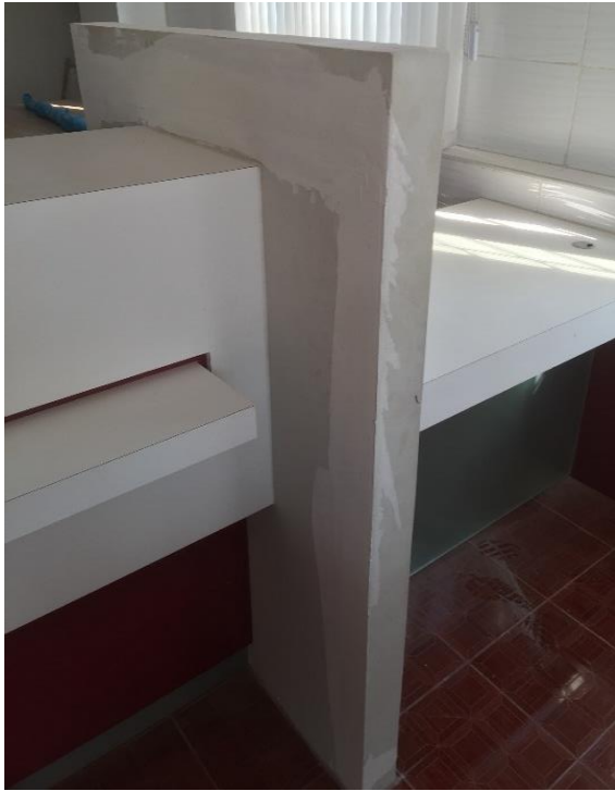
Fig:(26) Ground floor ရှိ Bulk Cash Counter နှင့် Teller Counter ကြားရှိ Partition အား ဆေးသုတ်ခြင်းလုပ်ငန်း မပြီးသေးပါ။ ( Putty touching ဖာထားသည်။)
