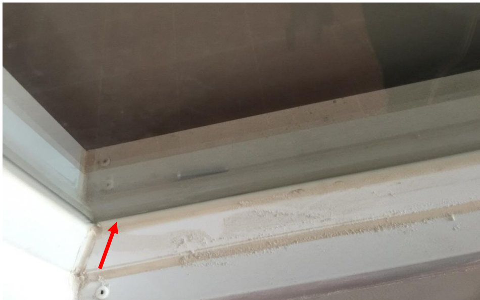
Fig:(53) Ground floor နှင့် First floor ရှိ Fixed glass partition များတွင် မှန်နှင့် Frame ဘေးပတ်ပတ်လည်အား Silocon ထိုးထားသည်ကို Rubber Liner ပြောင်းလဲအသုံးပြုပေးပါရန်။ ( As per specification)
